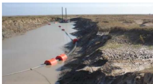
Figura 9. Tubería de descarga
