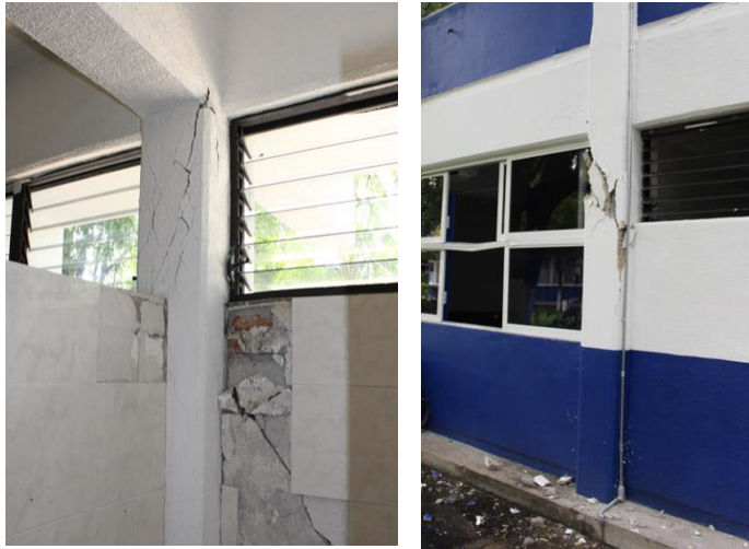
Fig. 2 Falla de columna corta Instituto Tecnológico de Zacatepec, septiembre 2017.
