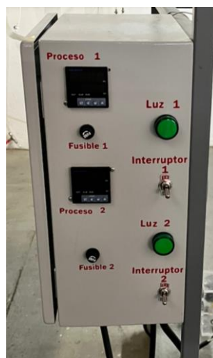
Figura 2.- Tablero eléctrico de controladores de temperatura
