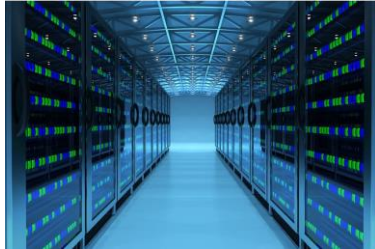
Figura 1. Almacenamiento de data warehouse , tomada de https://www.powerdata.es/data-warehouse
